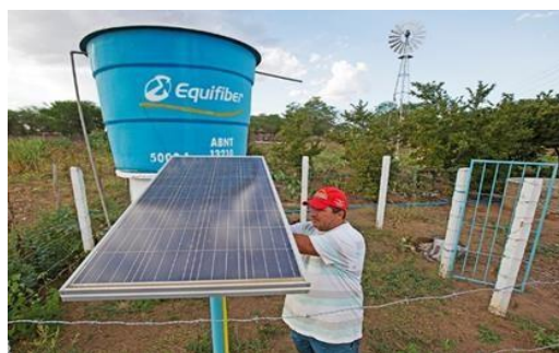
Foto 5 - Plano Emergencial – Campos irrigados: Poço, caixa d'água e placa solar para alimentar o 'kit irrigação'. Fonte: Acervo FIDA / Programa Semear Internacional
