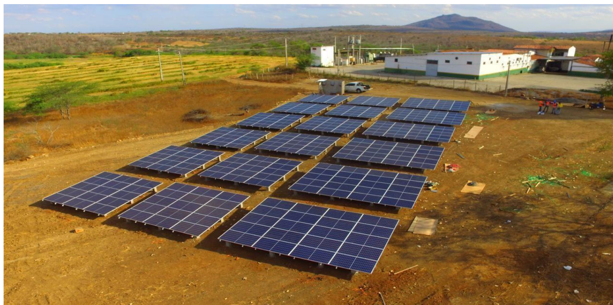
Foto - Sistema de energia solar implantado na COOAPECAL, município de Caturité. PROCASE: 2020.
